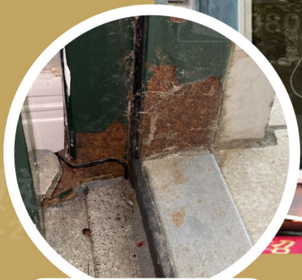
破損門框門檻
